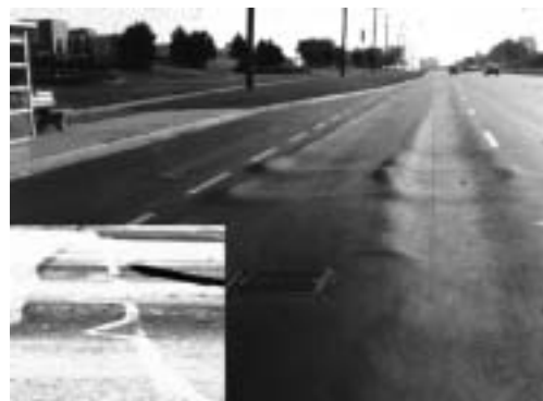
Photo 2-2 : Orniérage du béton bitumineux de la chaussée composite d'une importante route municipale
