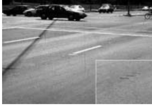
Photo 2-3 : Ressuage et orniérage de faible importance du béton bitumineux d'une chaussée composite
