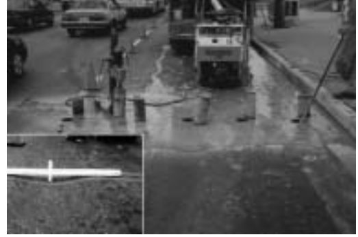
Photo 2-4 : Évaluation de l'orniérage du béton bitumineux d'une chaussée souple à forte résistance
