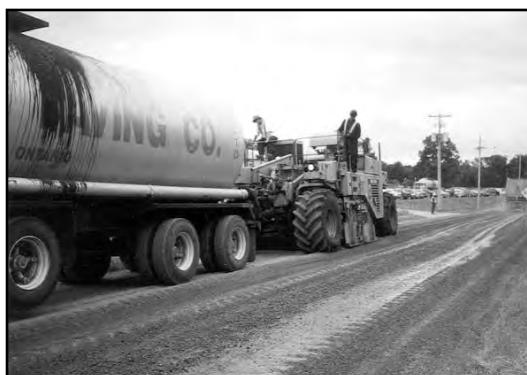
b) 150 mm de béton asphaltique stabilisé à l'émulsion de bitume, à 160°C plus 2 % d'eau.
