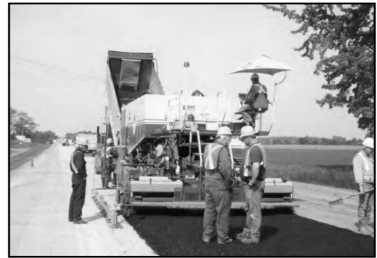
b) Livraison sur les lieux pour ensuite être posé à l'aide d'une finisseuse Midland.
