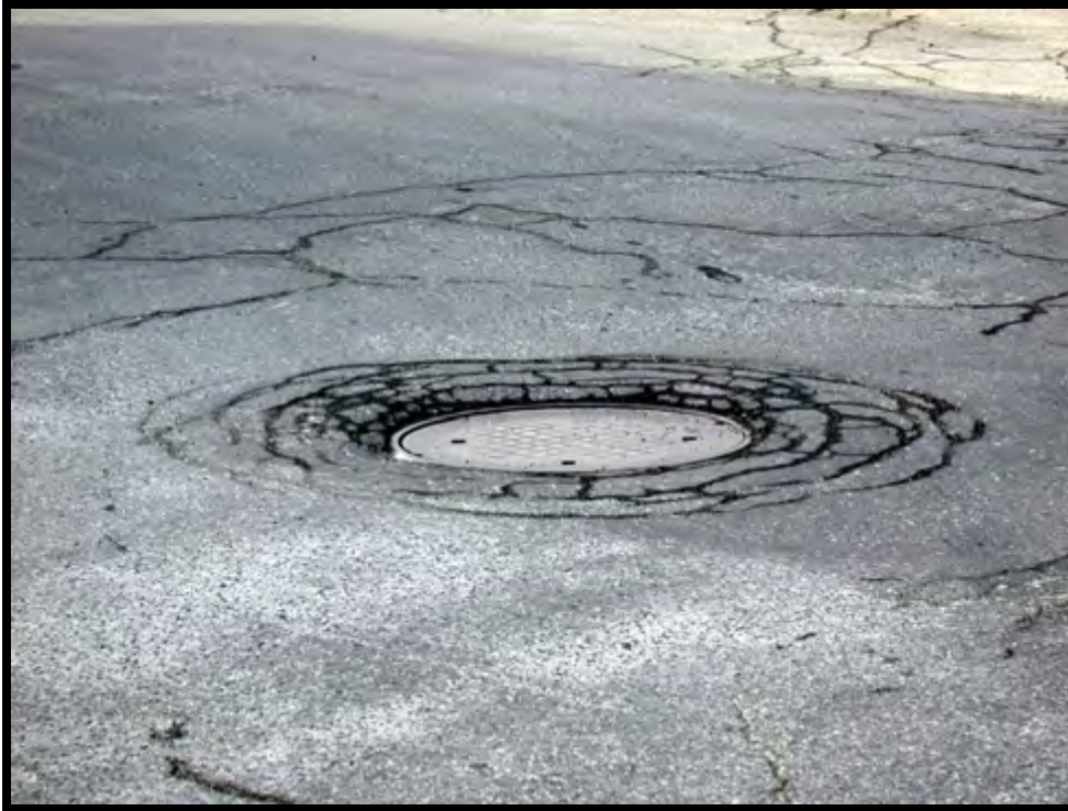
Photographie 2-3 : Fissuration concentrique.
