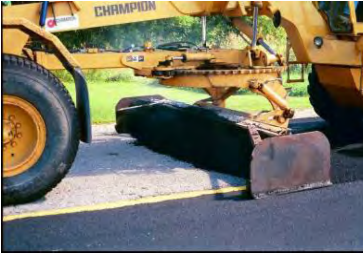
Figure 3–2 : L'application d'une couche d'éraflée d'un mélange à chaud de haute densité par une niveleuse munie d'un attachement ayant l'apparence d'une boîte. (Gracieuseté du ministère des Transports de l'Ontario)
