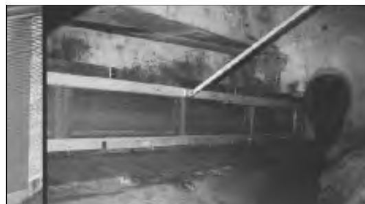
Figure A-19 : Filtres servant à enlever les déchets flottants des déversoirs des réseaux unitaires d'assainissement.
