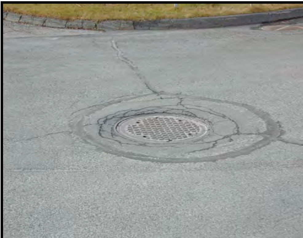
Photographie 2-4 : Fissuration concentrique et transversale.
