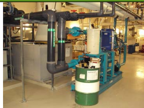
L'équipement de fabrication de glace est situé dans la salle technique de l'aréna Multiplex. Photo : Ville de Yellowknife.
