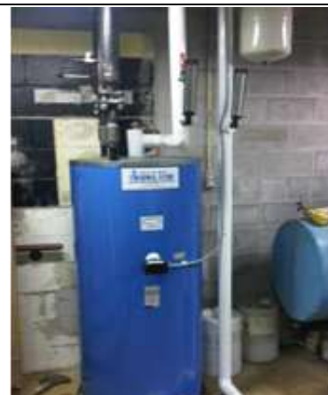
Réservoir à eau avec serpentin échangeur de chaleur Photo fournie par la Ville de Fredericton
